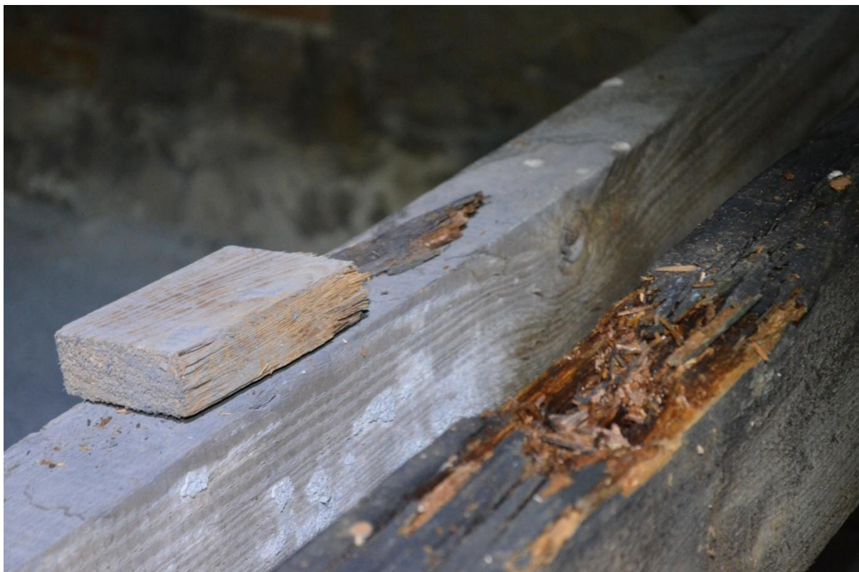
Zdjęcie nr 8 – Korozja elementu zastrzału więźby dachowej
