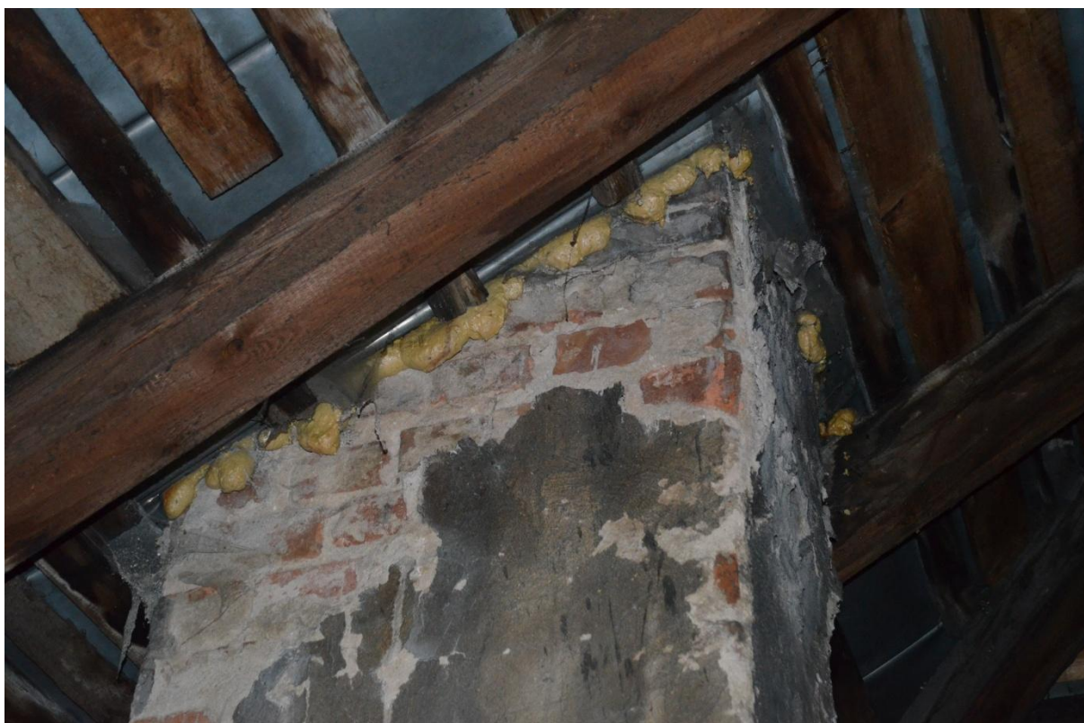
Zdjęcie nr 16 – Przejście komina przez połac dachową prowizorycznie uszczelnione
