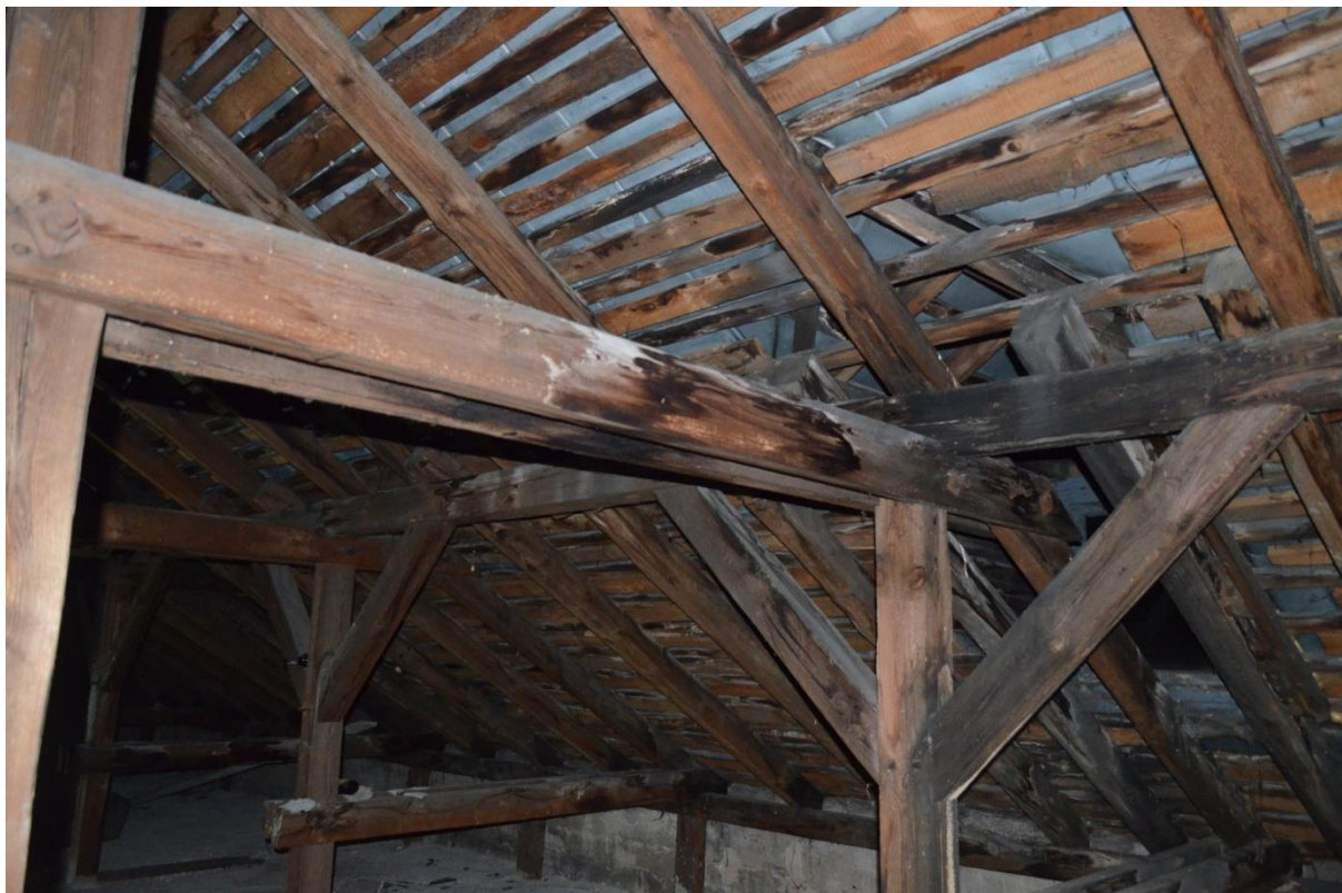
Zdjęcie nr 11 – Korozja więzby dachowej przy lukarnie
