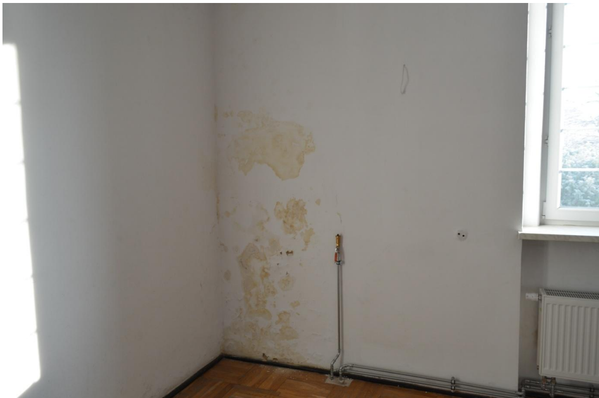
Zdjęcie nr 17 – Zacieki na ścianach w pomieszczeniach na piętrze
