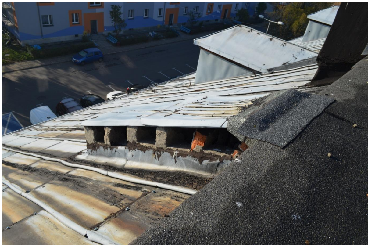
Zdjęcie nr 21 – Obróbka blacharska komina i połączenie z dachem papowym
