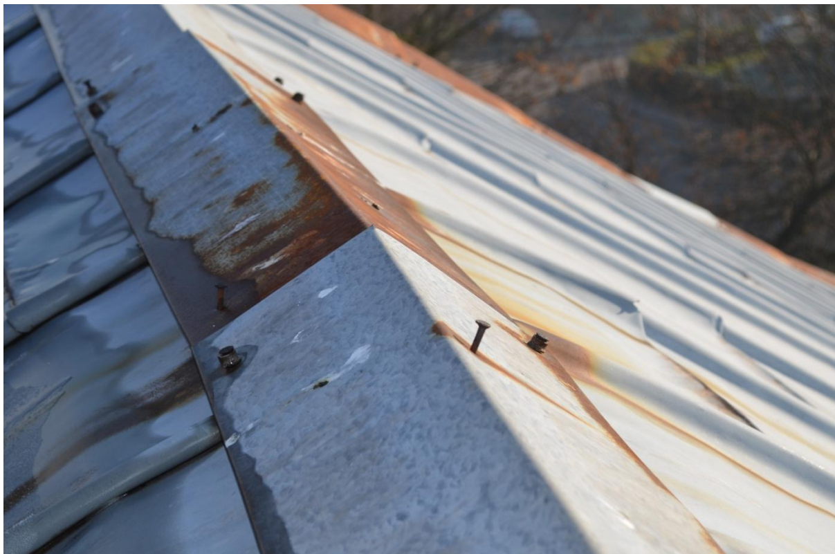
Zdjęcie nr 23 – Uszkodzone gąsioły dachowe
