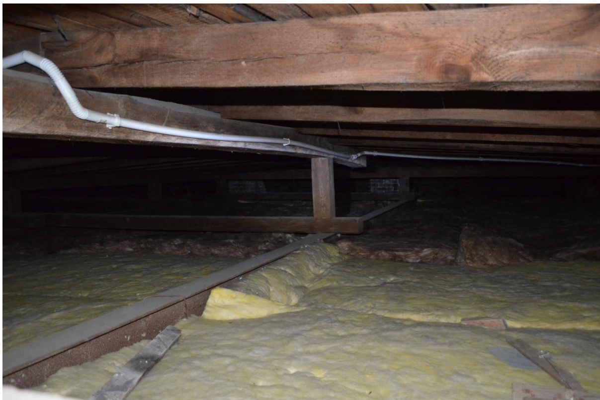
Zdjęcie nr 6 – Więżba dachowa nad sceną, widoczne oparcie na dwuteowniku i ugięcie
